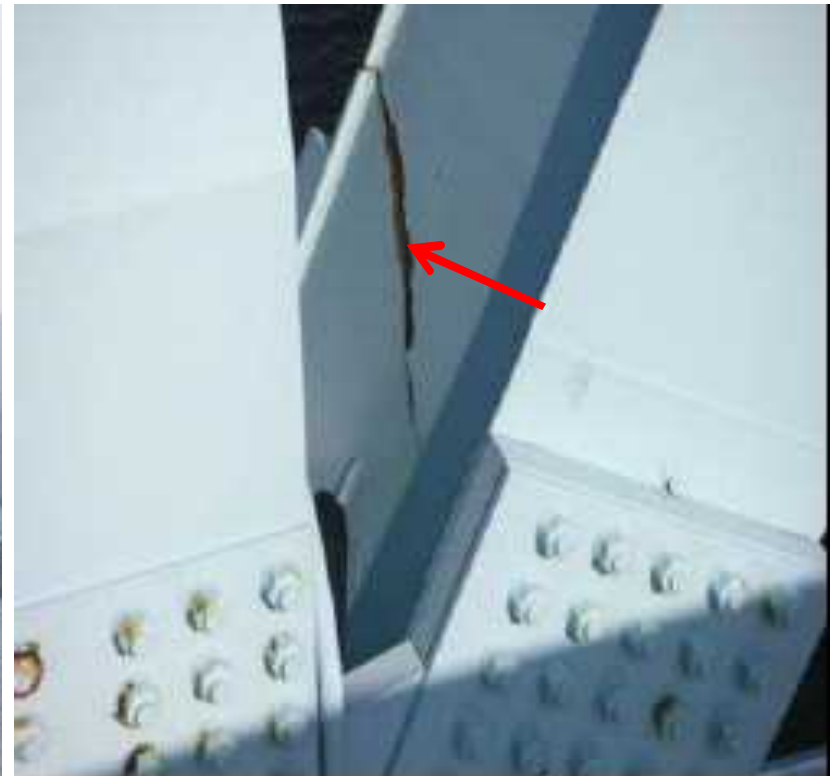
斜材溶接部を起点とする脆性破壊
