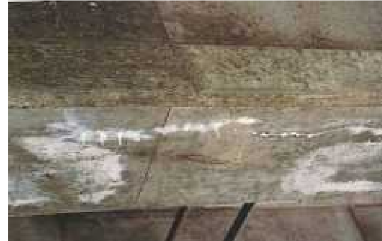
下フランジのPC鋼材に沿った漏水
