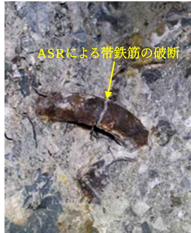
帯鉄筋曲げ加工部の破断
