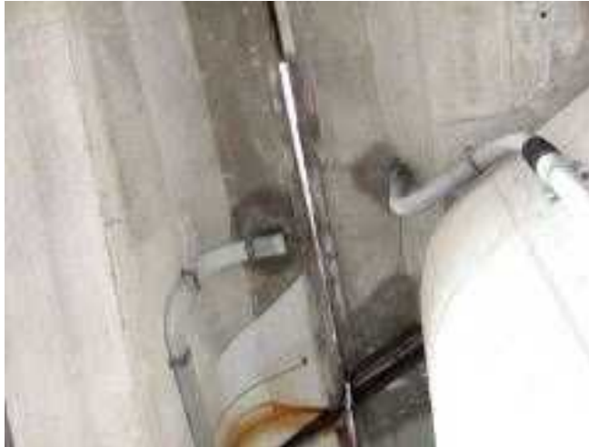
排水マス取付部からの漏水
