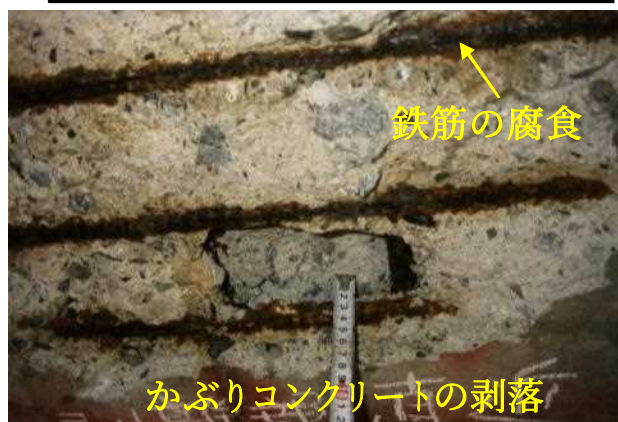
床版下面の中性化による鉄筋腐食状況
