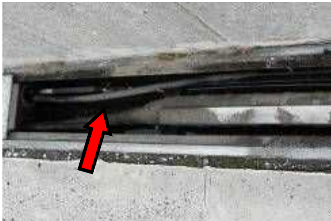
ハンドホールの滞水
