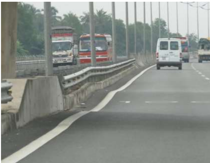
横断構造物付近の平坦性不良
