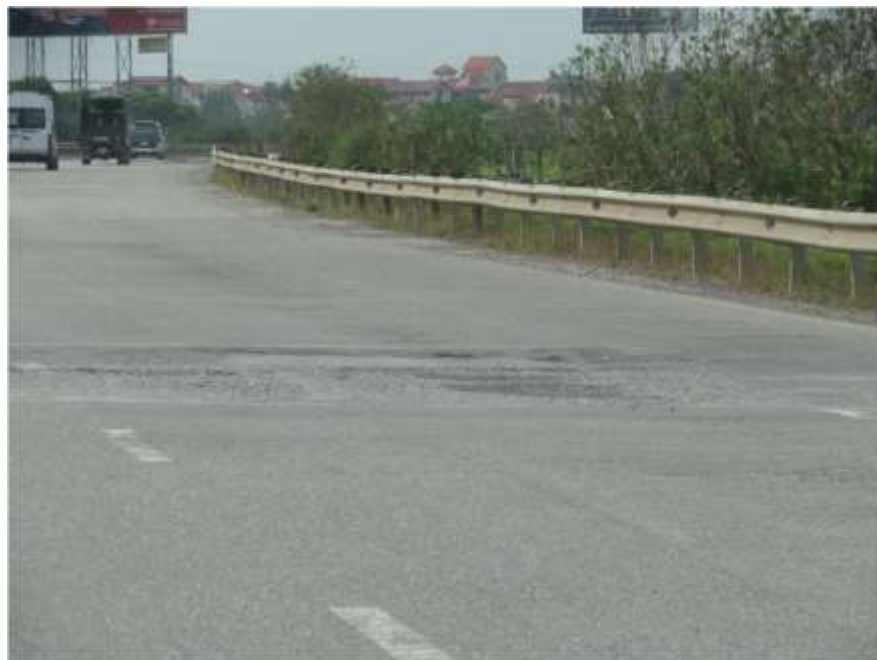
補修部の再損傷発生
